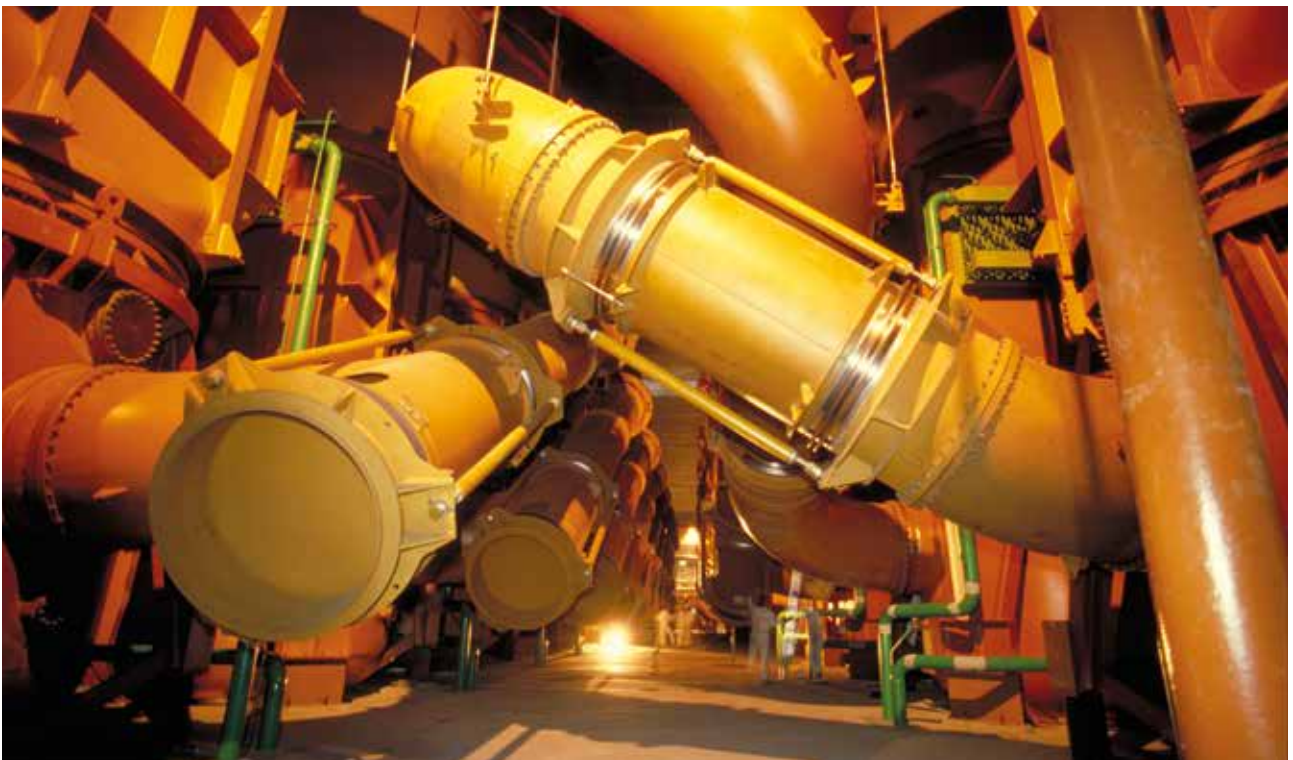
Groupes de diffusion de l'usine EURODIF Production en attente de démantèlement.
