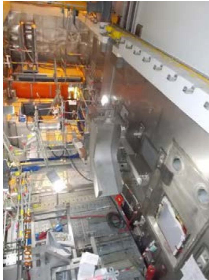
Photo 3 : intérieur de la cellule de tri et de cimentation des déchets.
