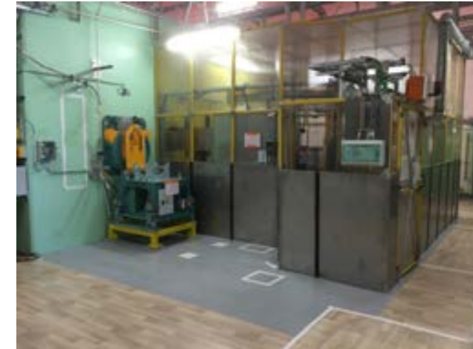
Photo 5 : hall 7004 en attente de raccordement actif
