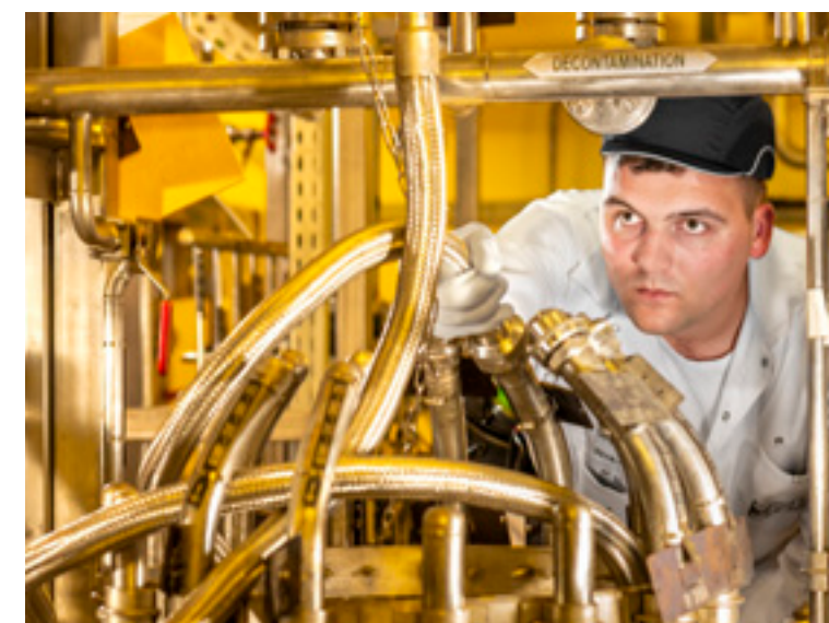
Vérification des installations.
